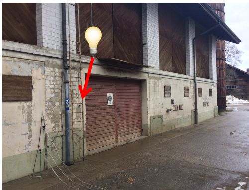
porte d'entrée du local (+ interrupteur de la lumière)
